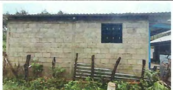
Foto 18: Repello de pared lado derecho del aula de primero primaria
